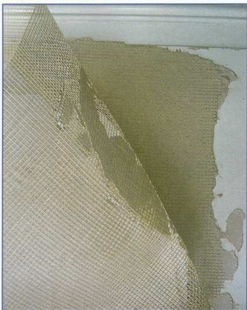
Le PRÉPENDUIT® est resté adhérent au support
